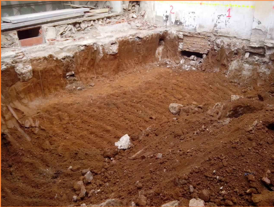
Foto 19. Vista general de la zona del pati un cop fet el primer rebaix general.
